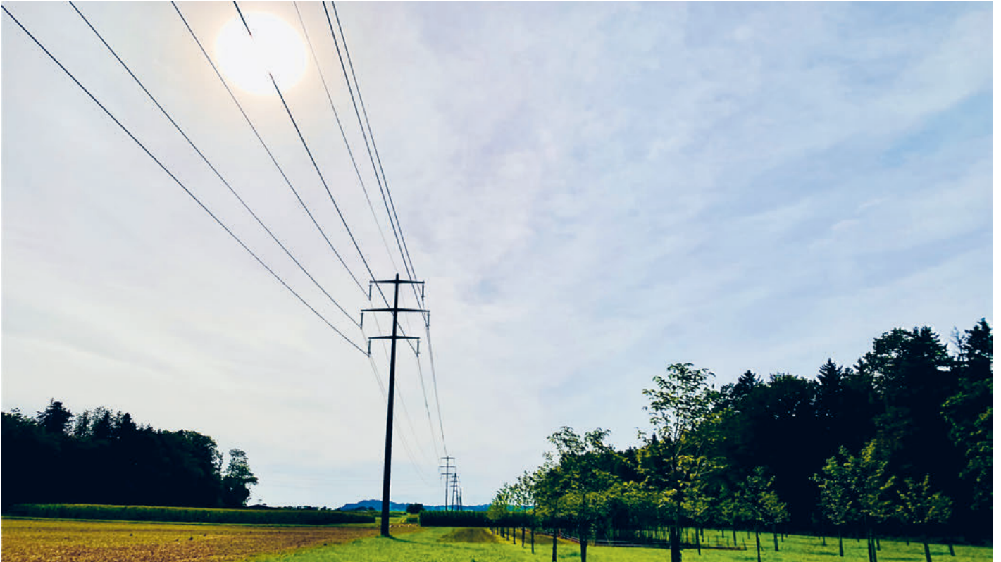
Freileitungsmasten in der Gemeinde Hohentannen
