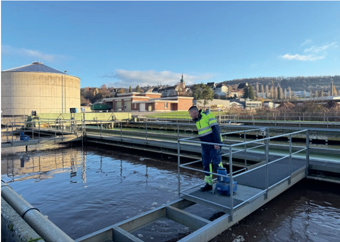
Betriebsleiter Sven Lüthi inspiziert die Kläranlage. (Foto: tw)
